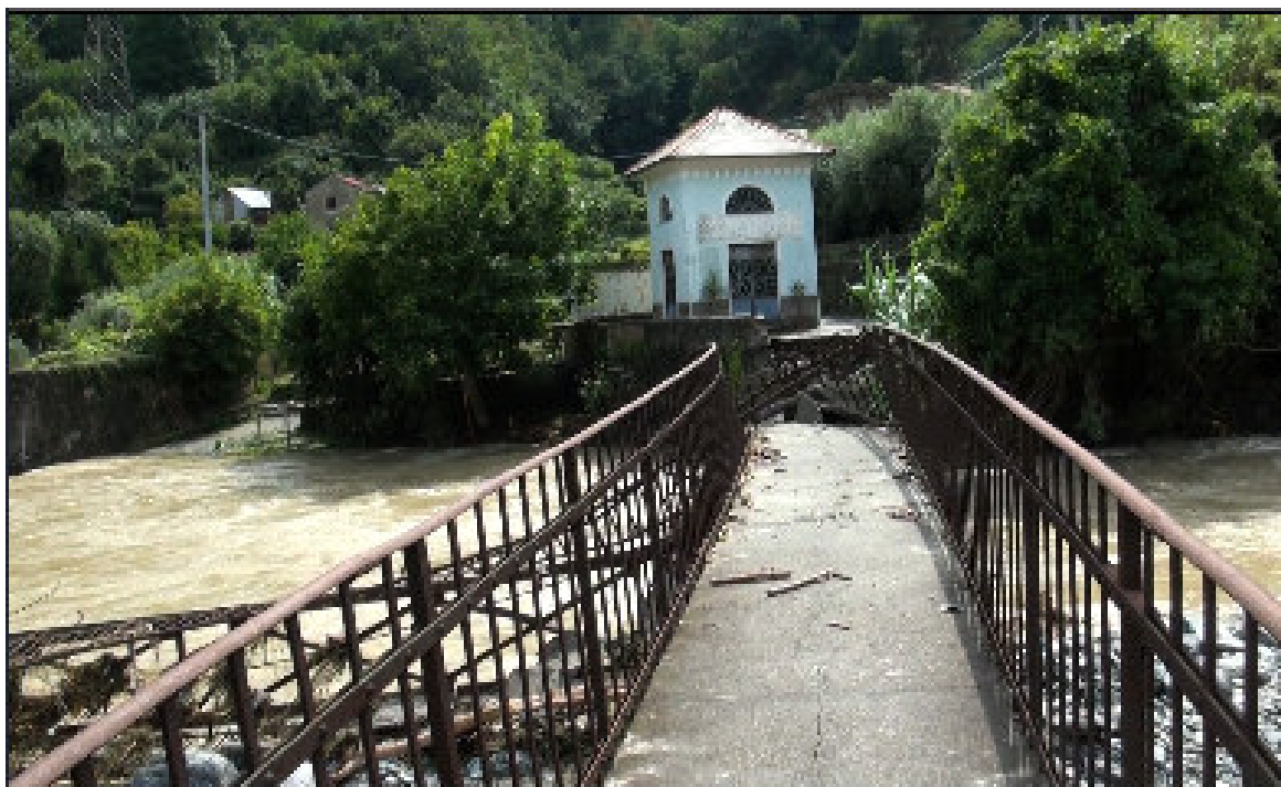
Foto 01- passerella pedonale sul Cerusa parzialmente crollata (agosto 2014)
